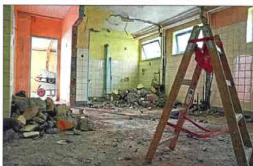
Die sanitären Anlagen der OTC-Trainingshalle werden jetzt saniert. Die Sportler wollten sie schon seit Langem nicht mehr nutzen. FOTO: KNOPP
